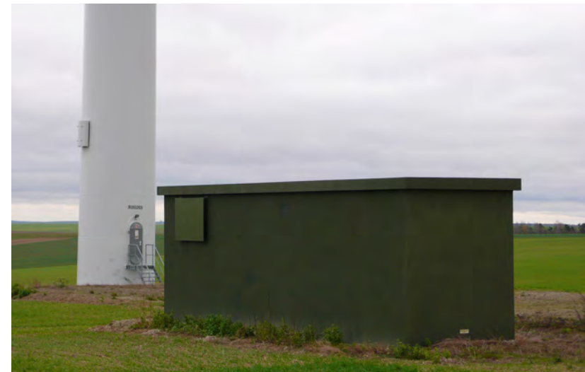
Exemple de poste de livraison présentant une couleur adaptée au contexte paysager et agricole
